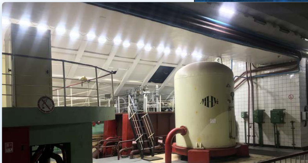
Машинный зал Шекснинской ГЭС
