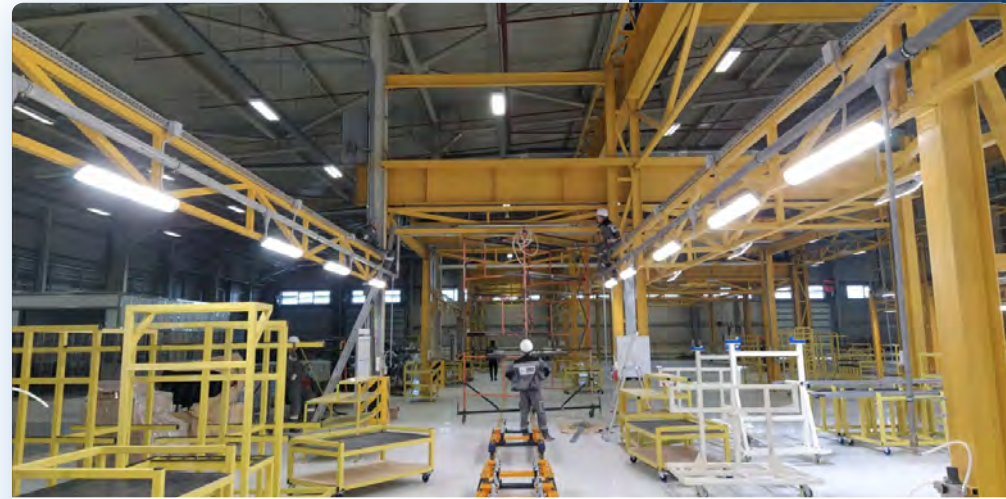
ТОО «Orbis Construction», г. Нур-Султан, Diora Quadro, Diora LPO/LSP SE
